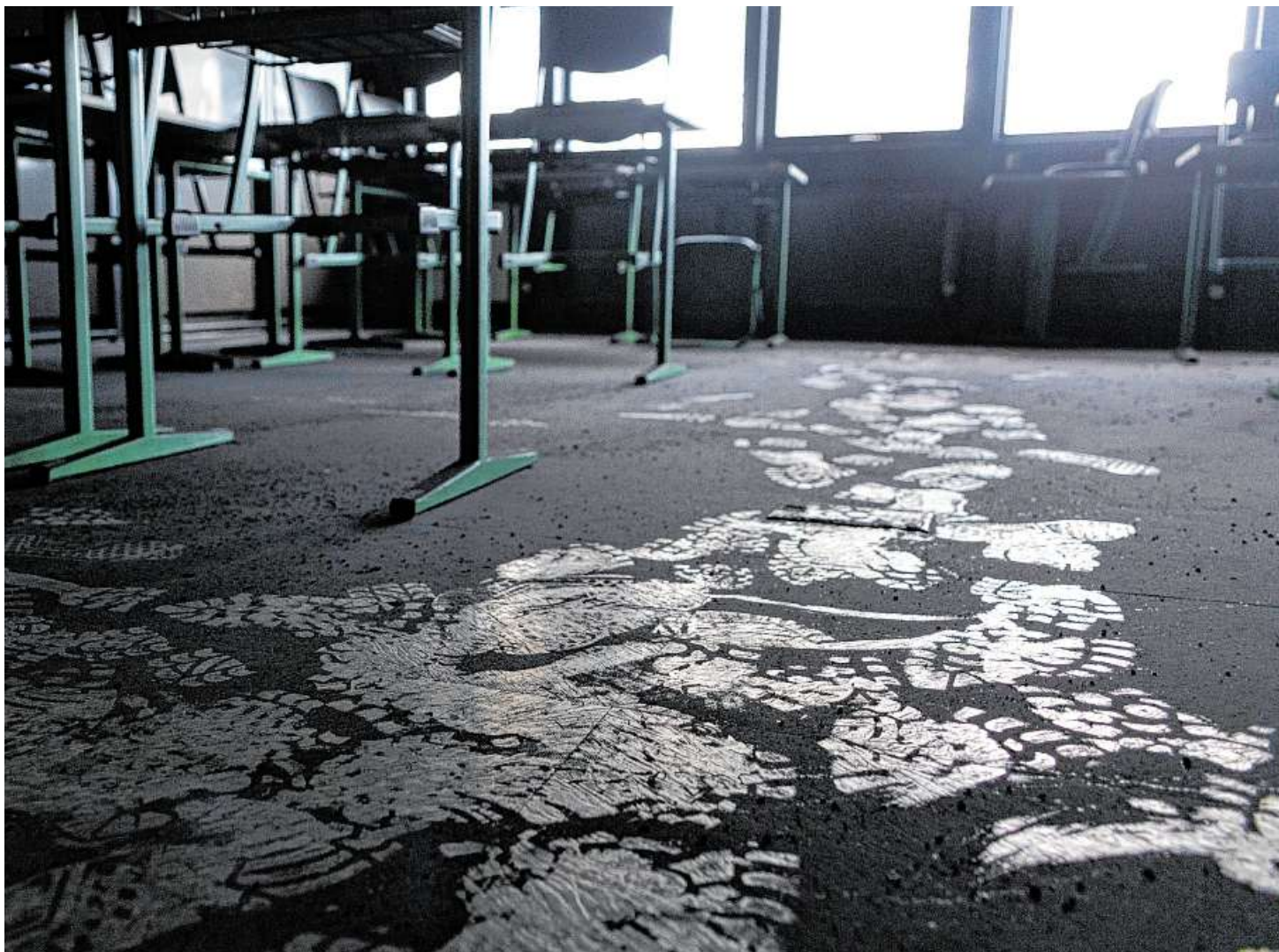
Beißender Gestank und dicke Rußschichten: Mehrere Räume an der KGS Leeste sind in Mitleidenschaft gezogen worden.
