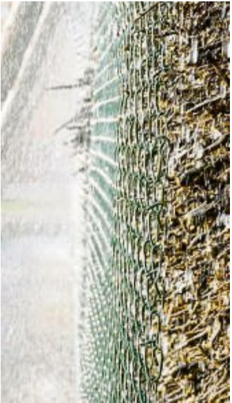
Der genaue Blick zeigt, dass Sanierungsbedarf besteht.
