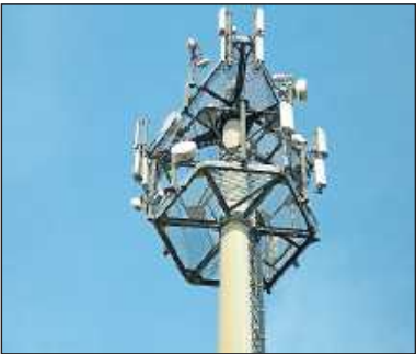
Die neue 4G-Mobilfunkstation in Alsenz. FOTO: TELEFONICA/O.
