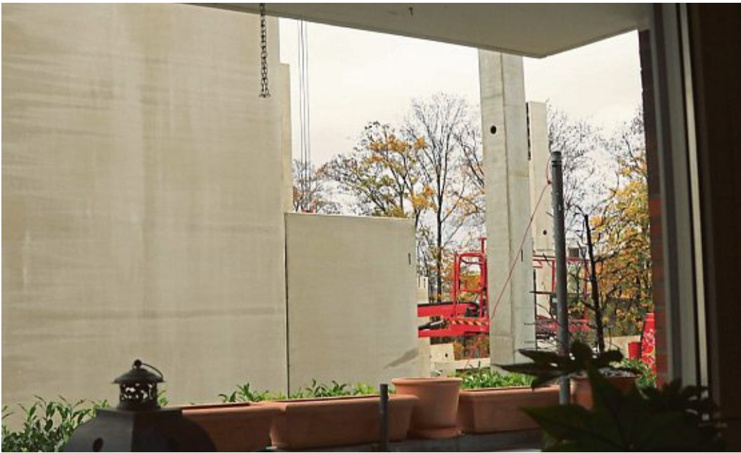
Die Bewohner des Mehrfamilienhauses klagen darüber, dass sie von ihren Balkonen aus nur noch die graue Wand des Supermarkt-Neubaus sehen.
