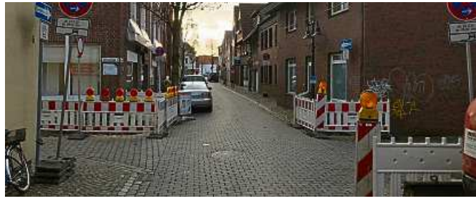
Wegen Arbeiten an den Hauptversorgungsleitungen muss die Königsstraße gesperrt werden. Foto: Stadtwerke Ostmünsterland
