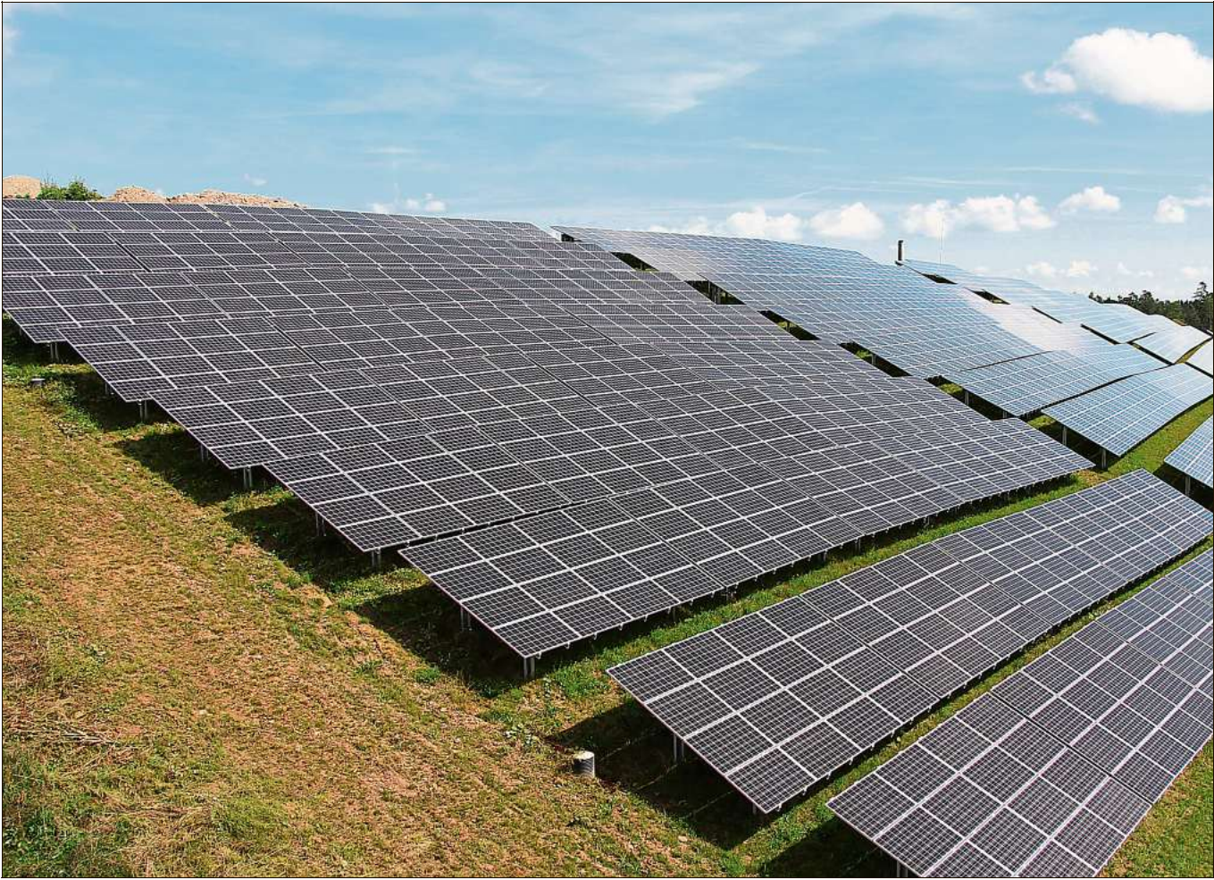
Die Photovoltaikanlage an der Deponie Oberhaugstett
