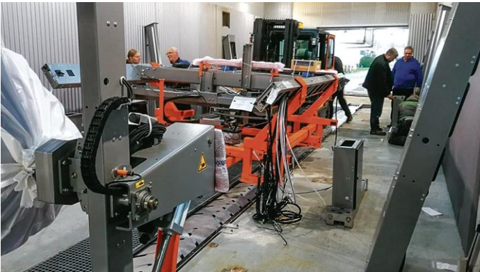
Wie viel Technik in einer Waschanlage steckt, sieht man erst, wenn man sie erneuert. FOTOS: CLEAN-WASH
