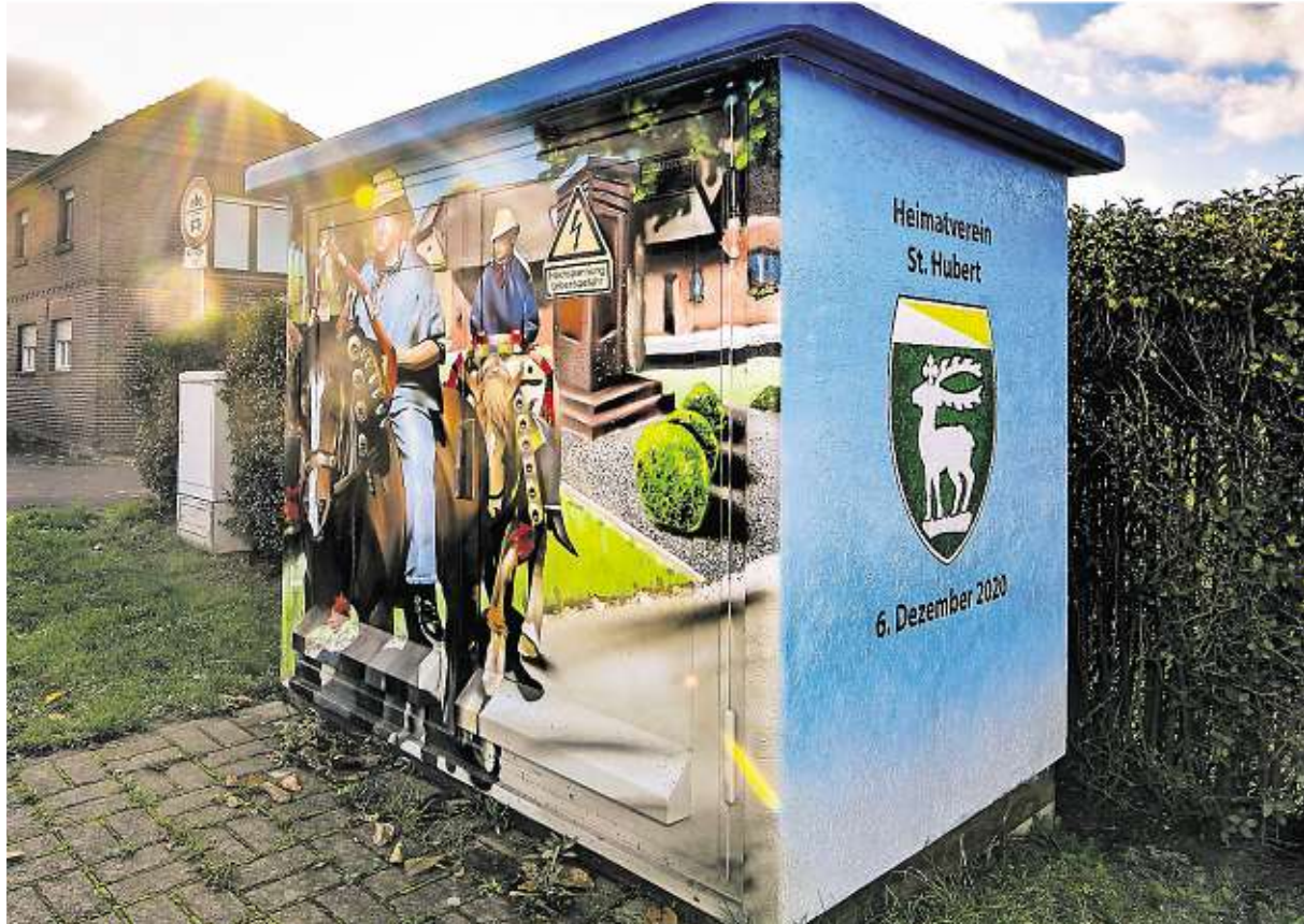
Die neu gestaltete Trafostation in Voesch ist das diesjährige Nikolausgeschenk des Heimatvereins St. Hubert an den Ort. Eine offizielle Übergabe fällt wegen der Corona-Pandemie aus.
