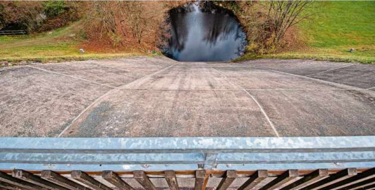
Eine Frau hat auf der Staumauer am Untreusee das Gleichgewicht verloren und ist neben dem Geländer die Böschung hinuntergefallen. Sie hatte großes Glück, dass sie nicht auf dem Beton direkt ins Auffangbecken gestürzt ist. Foto: Uwe von Dorn
