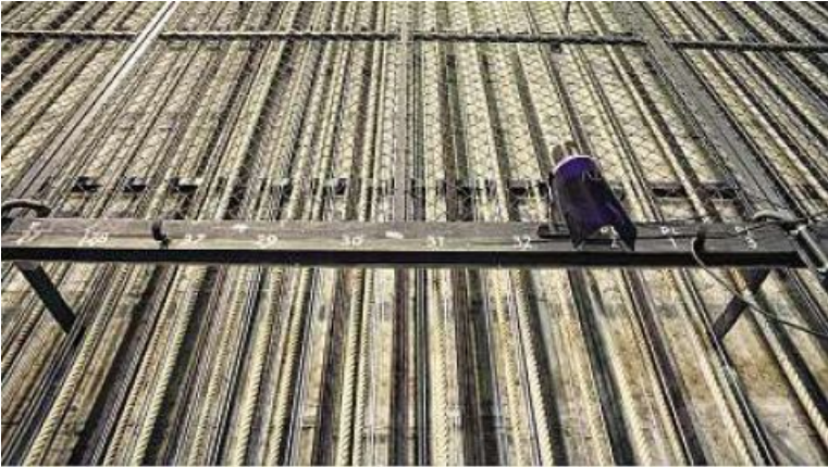
Die Kulissen werden im Theater noch mit Handzügen bedient. Das ist nicht mehr erlaubt, es wird aus Sicherheitsgründen auf motorbetriebene Seilzüge umgestellt.
