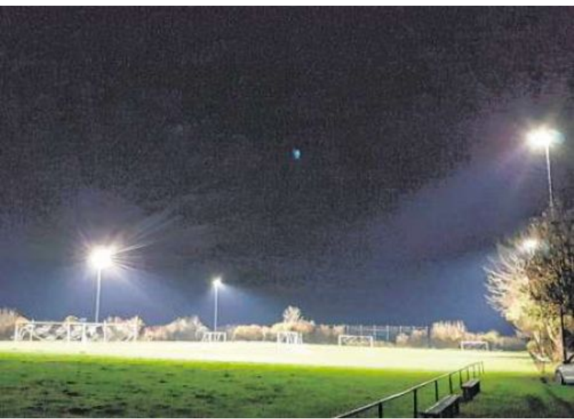
Insgesamt neun Masten auf dem Trainings- und Kleinfeldplatz des FSV Lamerdingen wurden mit LED-Technik umgerüstet.
