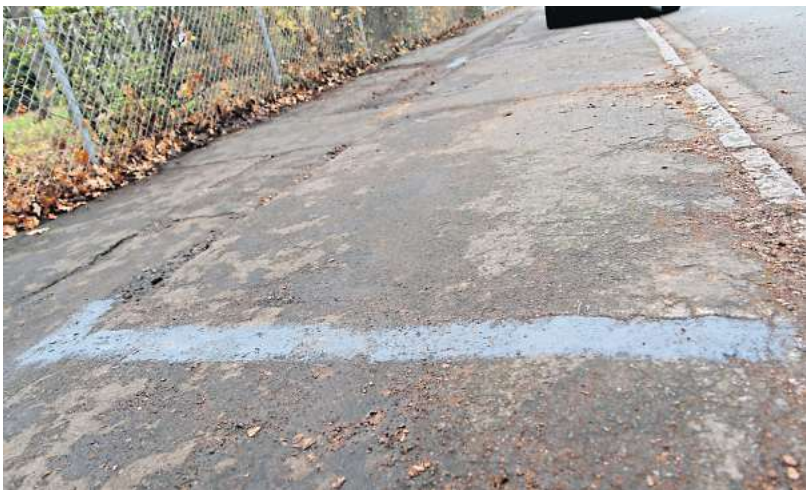
Übermalt, aber noch deutlich zu erkennen: Die ehemaligen Haltebuchten auf dem Gehweg.
