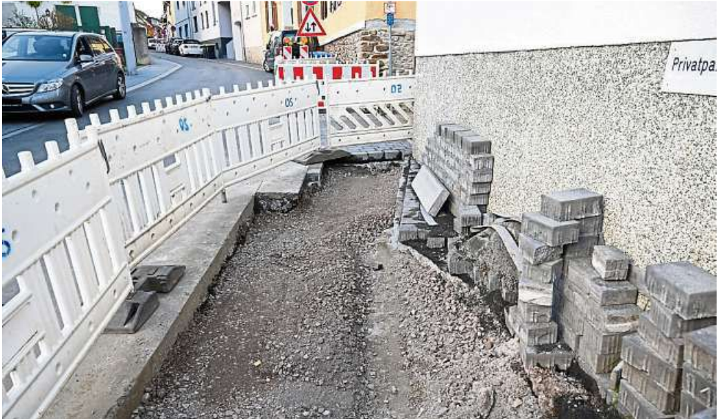
Weil die Telekom ein defektes Kabel austauschen muss, ist die nagelneue Asphaltdecke der Mühlstraße wieder aufgerissen worden. Foto: DigiAtel/Heibel
