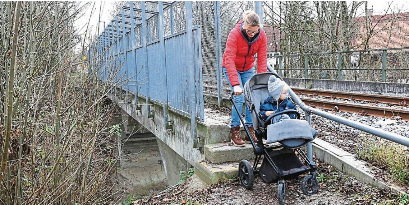
Mit Kinderwagen ist die Benutzung der Fußgängerbrücke am Bahnhof Nord in Peiting eine echte Herausforderung, nach dem barrierefreien Ausbau sollen zumindest die Stufen der Vergangenheit angehören. FOTOS: HEROLD
