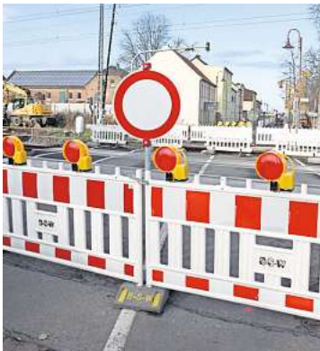
Der Bahnübergang in Markranstädt ist noch bis Mittwoch komplett gesperrt. FOTO: A. KEMPNER
