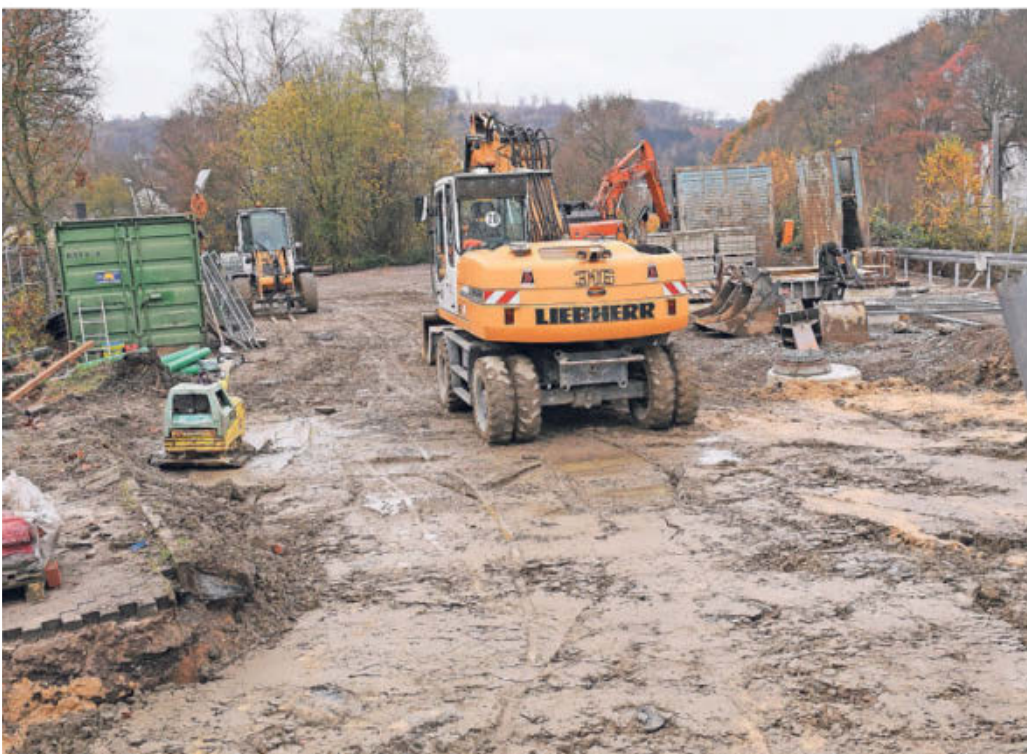
Vom dem fast drei Millionen Euro teuren Regenrückhaltebecken an der Siebenecker Straße ist nichts mehr zu sehen. Die Bauarbeiten gehen dem Ende zu, ab dem Frühjahr kann der Parkplatz gegenüber des Friedhofs wieder genutzt werden.
