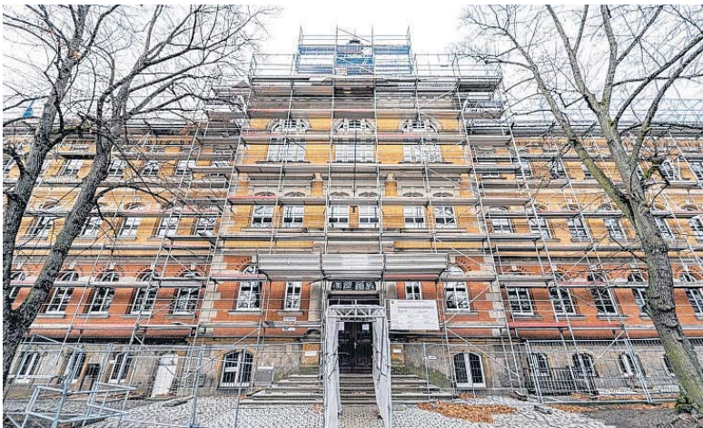
Mehrere Ziergiebel an der Trützschler-Oberschule, auch der über dem Haupteingang, sind vom Zahn der Zeit stark angegriffen. Jetzt sollen sie schnell saniert werden. FOTO: DAVID RÖTZSCHKE
