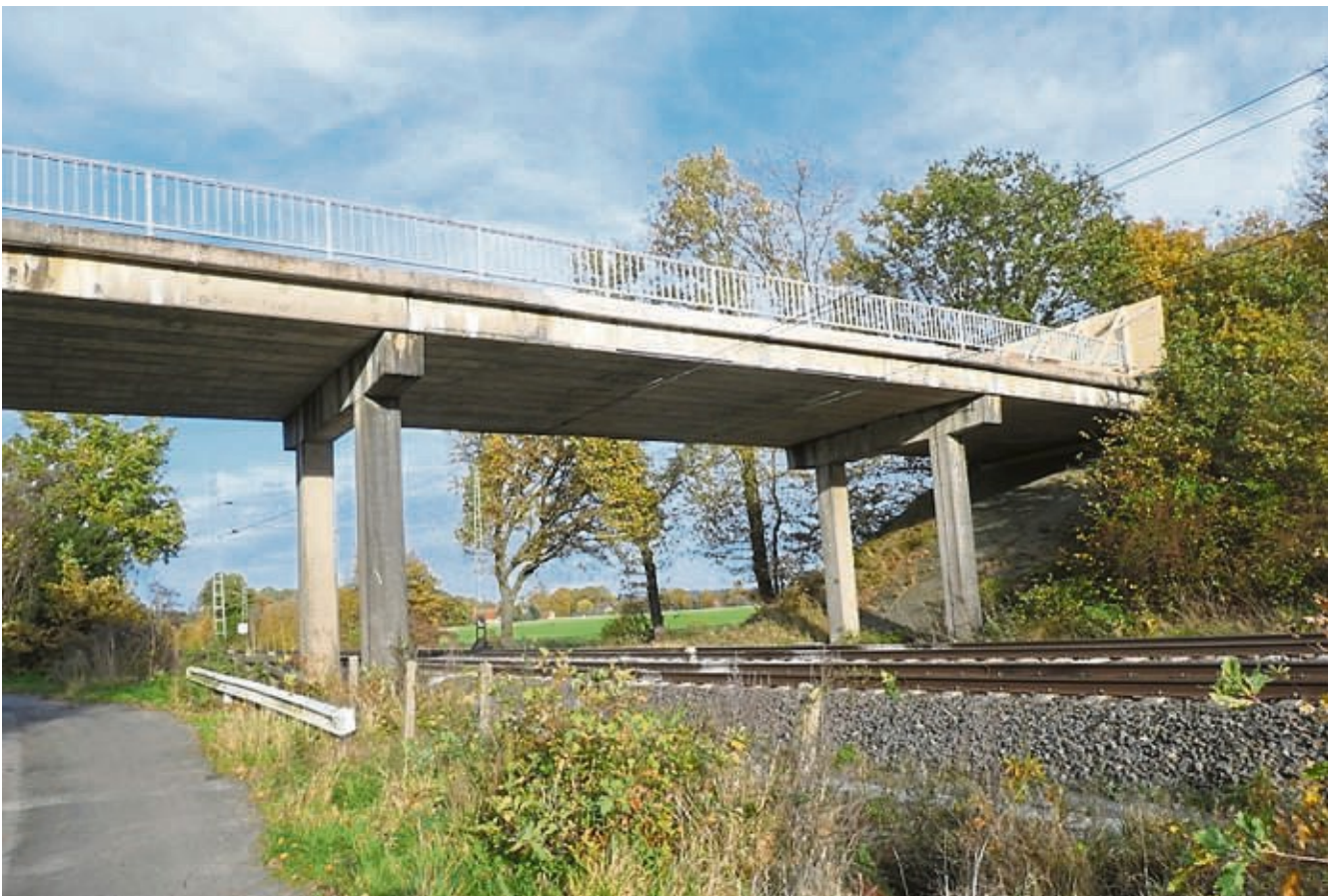
Die Bahnbrücke „In den Wiesen“ ist auffällig und soll abgerissen werden. Schon jetzt ist sie aber für den Verkehr gesperrt. Ähnlich war dies bei dem ähnlichen Bauwerk im Ort. Diese Brücke ist bereits neu gebaut. FOTOS: REINHOLD KASPER
