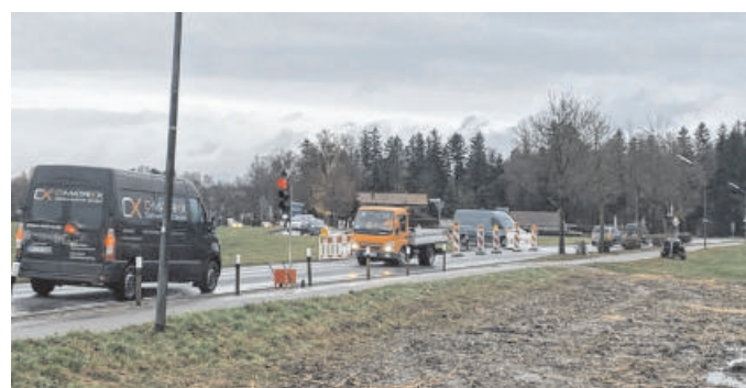
Die Straßenschäden im Bereich Thürhamer-/Ebersberger Straße wurden ausgebessert. Ansonsten bleibt dort vorerst alles beim Alten.
