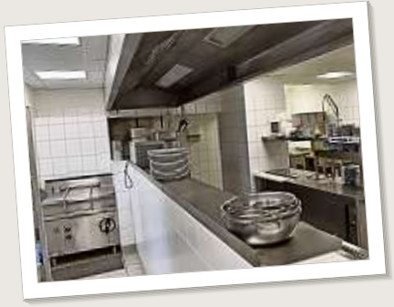
Die Küche wurde 2016 neu gemacht. Im Zuge dessen wurde auch eine neue Abluftanlage eingebaut.
