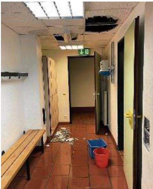
Wasser tropft durch die Decke in den Flur, der zu den Umkleieräumen führt. Platten sind zu Boden gestürzt.
