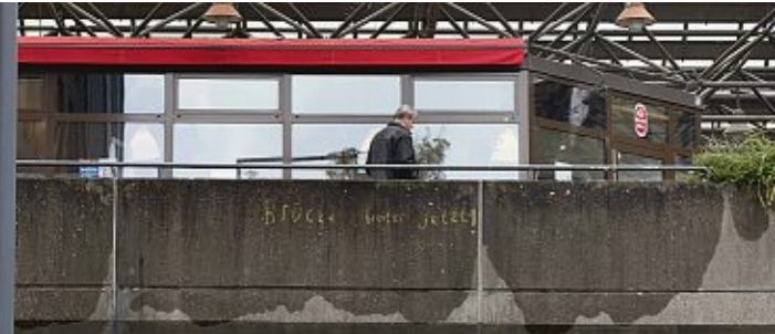
Eine Forderung mit drei Buchstaben ist auf dem Betonbauwerk verewigt: „Brücke runter jetzt“.
