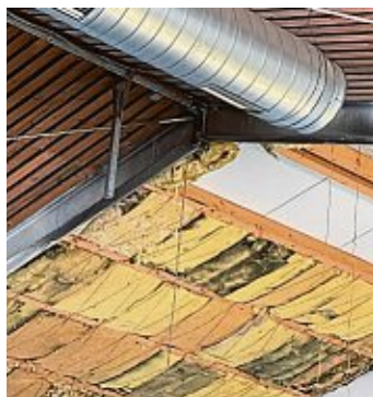
Die Spuren des Brands sind am Stahlträger noch sichtbar.
