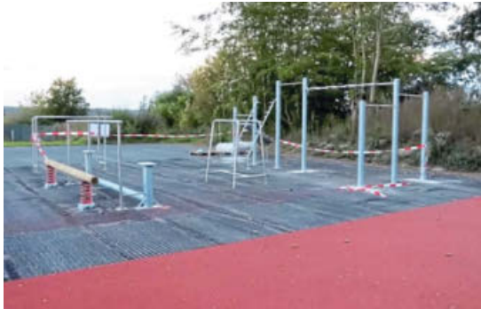
Die Geräte für das Training mit dem eigenen Körpergewicht sind bereits installiert.
