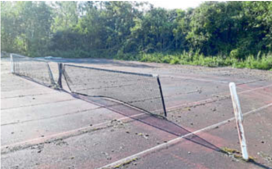
Die alten Tennisplätze aus den 1970er-Jahren waren in keinem guten Zustand mehr.
