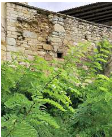
Sanierungsbedürftig: die Mauer am Askanierweg in Burgwerben
