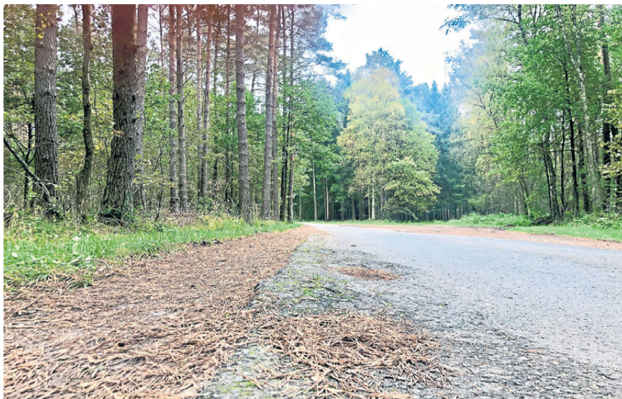
Die Wurzeln machen die Straße von der ehemaligen Bundesstraße 3 nach Friedrichsens zu einer Holperstrecke. 2022 soll die Straße saniert werden. Foto: at
