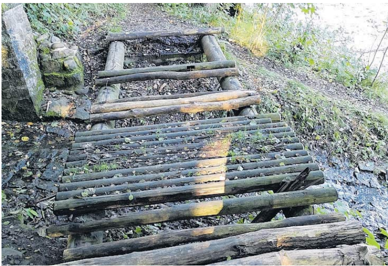
Am Wanderweg von Niederwiesa nach Flöha (sogenannter Peitzweg) nahe dem Zusammenfluss von Zschopau und Flöha ist eine Holzbrücke über einen etwa einen Meter hohen Graben kaputt.
