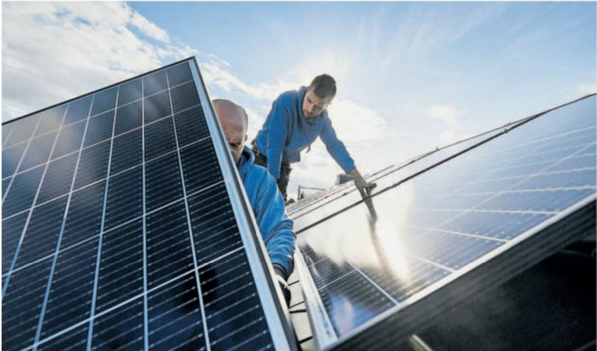
Mit Steuervergünstigungen will die Regierung in Luxemburg den Ausbau der Fotovoltaik fördern.
