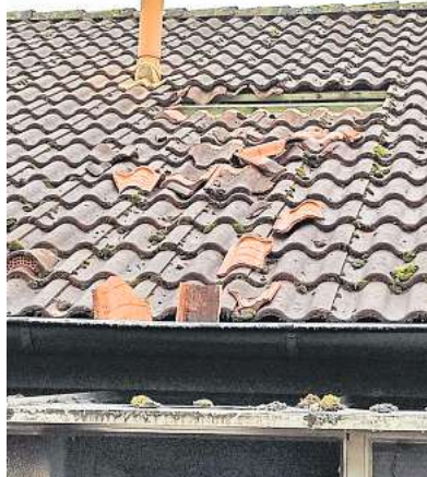
Im Dach des Hauses ist ein Loch. Vermutlich ist das Gebäude nicht mehr zu retten und muss abgerissen werden.
