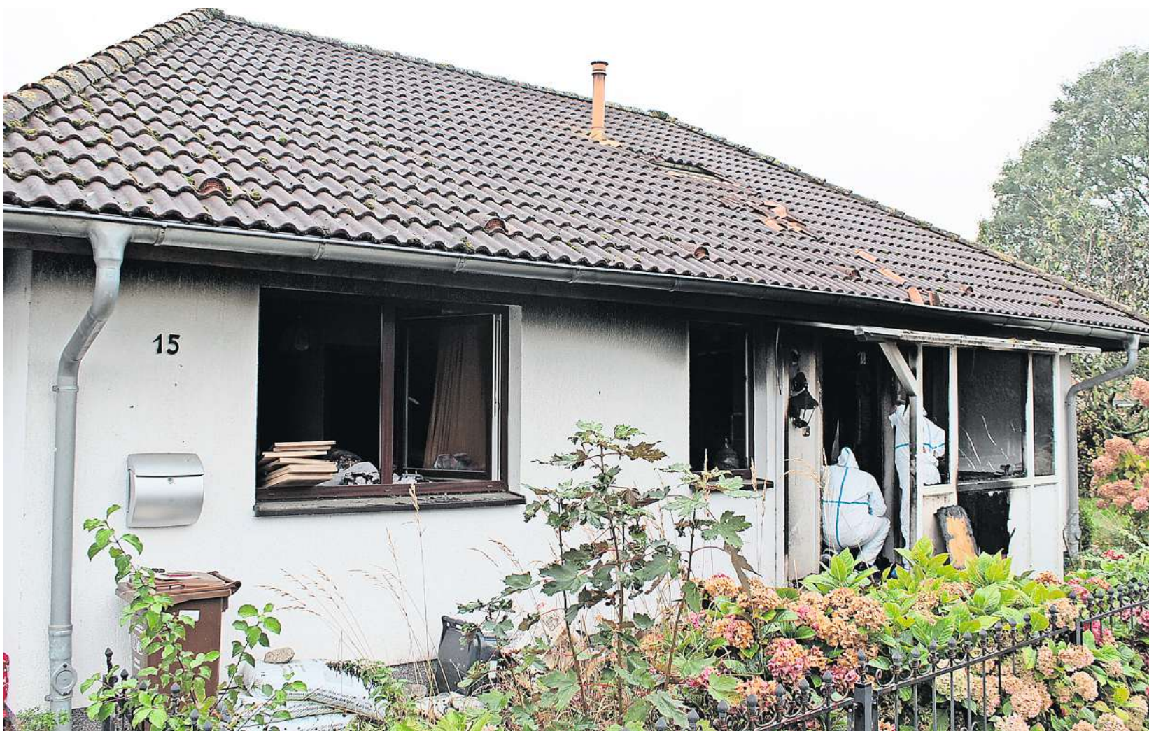
Die Spurensicherung ist in Groß Lüdershagen im Einsatz. In diesem Haus starb am Montag ein Mensch bei einer Verpuffung.
