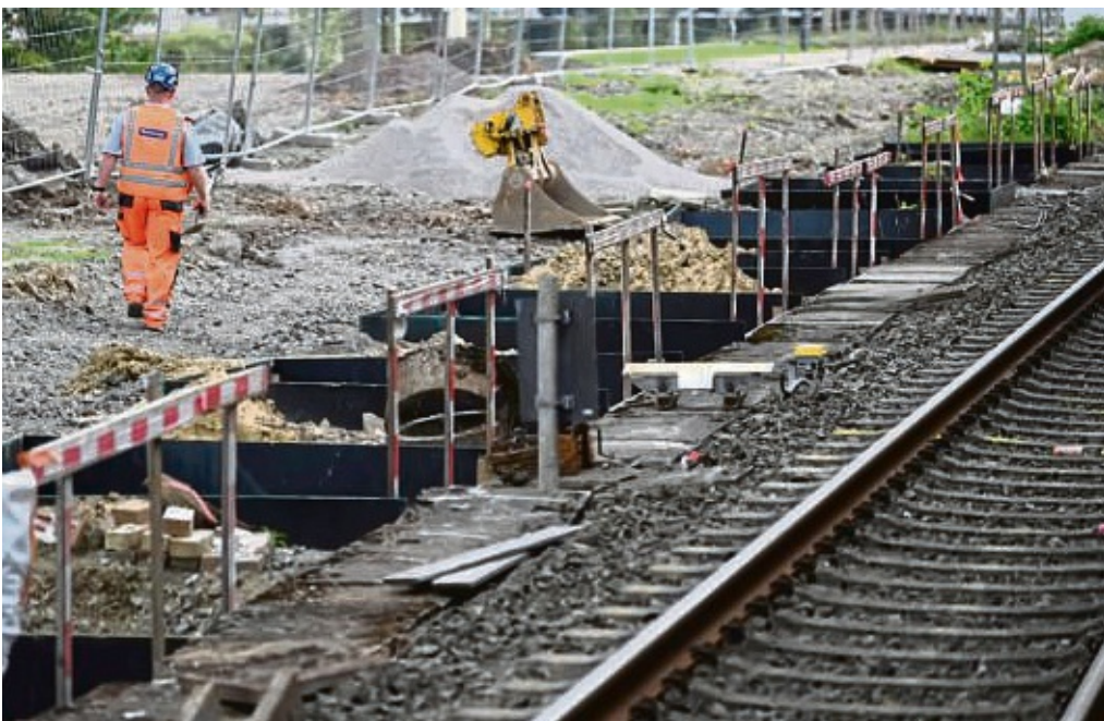
Die Ruhr-Sieg-Strecke ist seit dem Unwetter Mitte Juli zwischen Werdohl und Hagen gesperrt. Vor allem im Bereich Altena ist die Strecke stark beschädigt worden.
