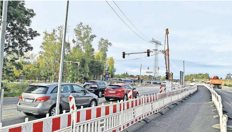
An der Baustellenampel in Birkenwerder kam es in den vergangenen Tagen zweimal zu Störungen, unter anderem durch die Kollision eines Lkw mit der Oberleitung. Umgehend wurde der Schaden behoben.
