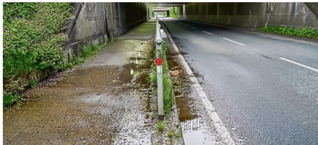
Ein Dauer-Problem: Durch Wasser, das aus dem Bahndamm tritt, steht der Geh- und Radweg unter den sieben Brücken regelmäßig unter Wasser.
