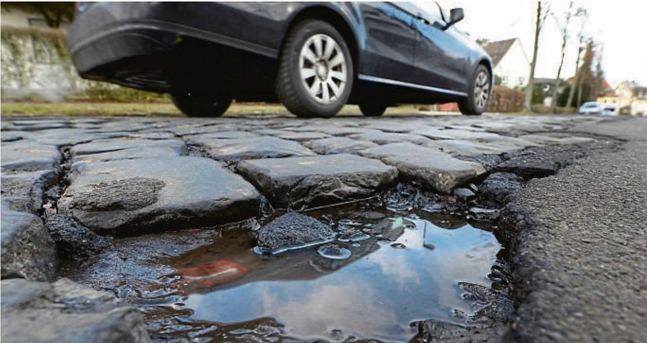
Tiefe Schlaglöcher: Die Heinrich-Heine-Straße, die Verbindung zwischen Wehlheiden und der Südstadt, gilt als eine der marodesten Straßen im Kasseler Stadtgebiet. Wann sie erneuert wird, ist nach wie vor unklar.
