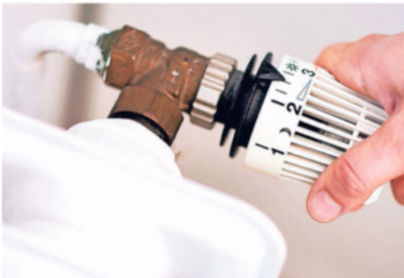
Die Zahl der reparaturbedürftigen Heizanlagen im Ahrtal ist immens. Handwerker wie Wolfgang Worms kämpfen gegen die Zeit. FOTO: DPA
