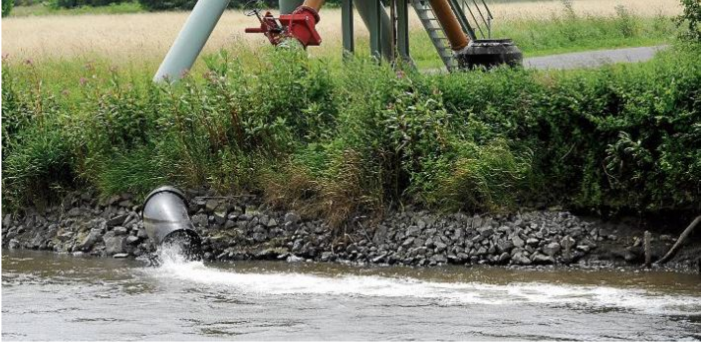
Relativ kleines Rohr, aber große Wirkung auf die Natur: Hier leitet K+S Salzwasser in die Werra und damit in die Weser ein.
