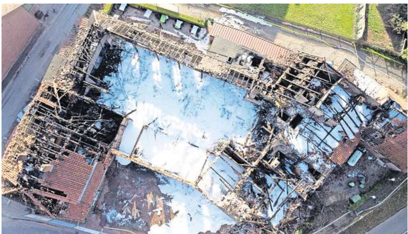
Am Tag danach. Der Brand des Restaurants hat sichtbare Spuren hinterlassen. Der Innenraum der Gebäude wurde mit Löschschaum geflutet.
