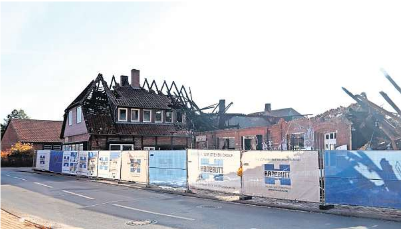
Von dem Lokal San Stefan im Schneereener Ortskern ist nur noch eine Ruine übrig. Am Sonnabend kam es zu Probleme mit dem Nahwärmenetz.
