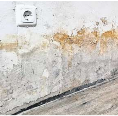
Die Wände der Wohnung an der Northeimer Wende sind durchnässt und verschimmelt.
