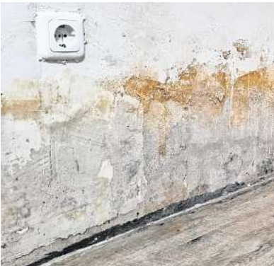
Die Wände der Wohnung an der Northeimer Wende sind durchnässt und verschimmelt.
