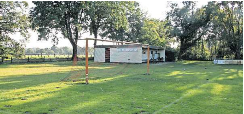
Das Umkleidegebäude auf dem Sportplatz in Dedenhausen ist sanierungsbe- dürftig.
