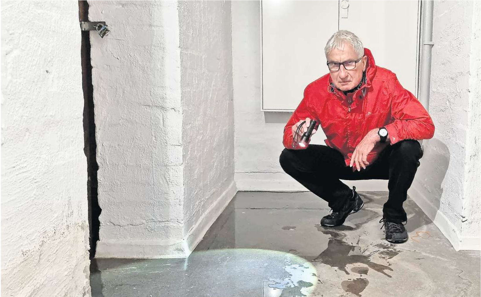
Horst-Werner Korth unterstützt die betroffene Familie Bashir. Der 71-Jährige wohnt im selben Mehrfamilienhaus. Dort ist das Wasser auch in die Kellerräume vorgedrungen. FOTOS: MANUEL BEHRENS
