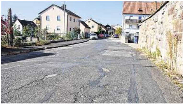
Mehrere schwere Wasserrohrbrüche haben es gezeigt: Die Weinbergstraße in Rimpardorf ist dringend sanierungsbedürftig.
