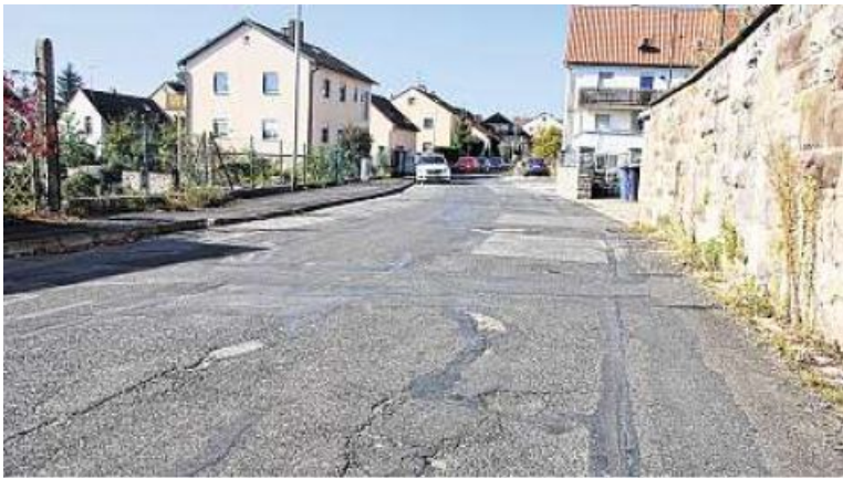
Mehrere schwere Wasserrohrbrüche haben es gezeigt: Die Weinbergstraße in Rimpark ist dringend sanierungsbedürftig. FOTO: CHRISTIAN AMMON
