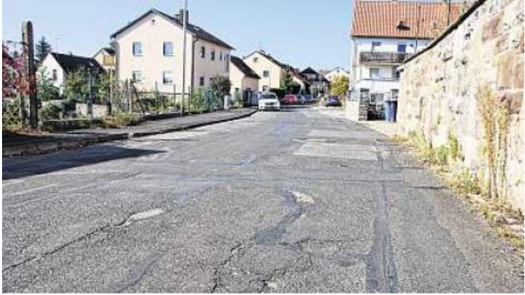
Mehrere schwere Wasserrohrbrüche haben es gezeigt: Die Weinbergstraße in Rimpark ist dringend sanierungsbedürftig.
