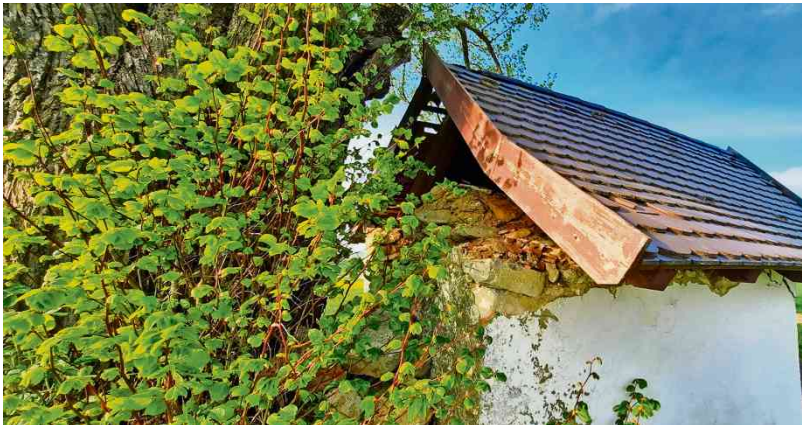
Der durch den Lindenast verursachte Schaden war immens. Die Rückseite war stark beschädigt. Risse im Mauerwerk waren zusätzliche Hinweise auf die mangelhafte Statik.
