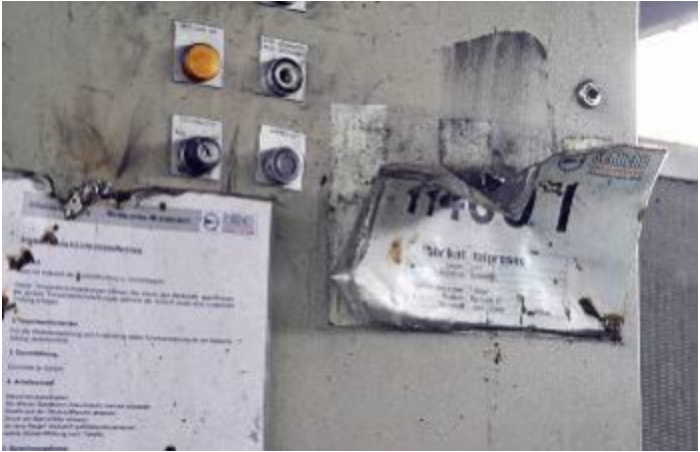
Hier wird die Hitzeeinwirkung sichtbar.
