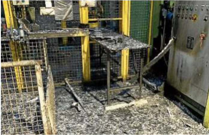
Die Lüftungsanlagen war auf die Maschine gestürzt.
