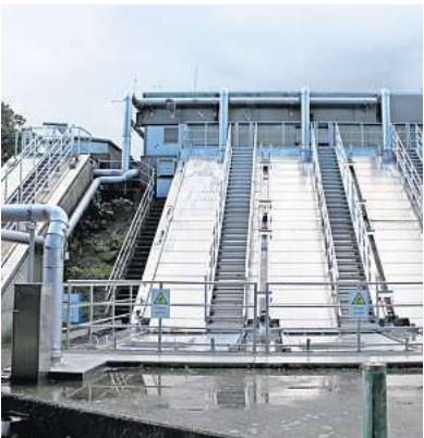
Über die Pumpanlage kommt das Abwasser ins Klärwerk Gümmerwald.
