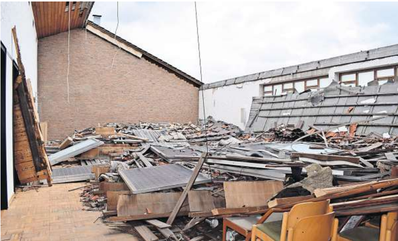
Einsturz im April 2020: So sah der Kirchraum danach aus. Die Kirchenleitung hat sich gegen Sanierung und Neubau entschieden.
