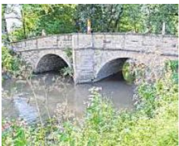
Die Schäden an der Brücke zeigen, dass hier schnellstens gehandelt werden muss. FOTO: HANNIS FRIEDRICH
