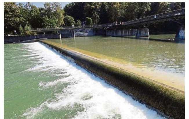
An dem Wehr kann eine Wasserwalze entstehen.
